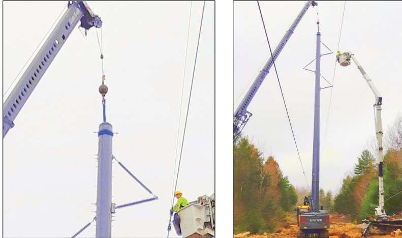
Figures 24a et 24b : Grue avec élingue à nœud coulant installant un poteau de 95 pi [29 m] pour un circuit de 115 kV
